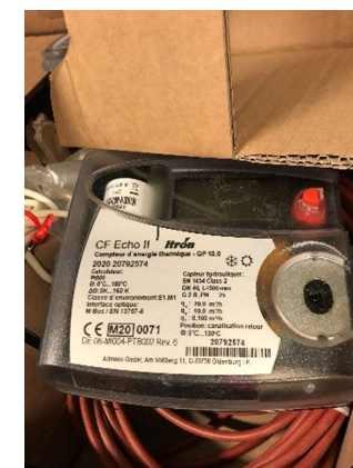
Compteur énergie solaire utile
