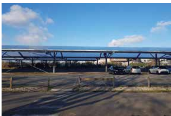
La centrale de Corbas.
